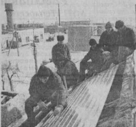
Бригада плотников Рима Худайбердина в составе С.Аскарова, Г.Хазиева, Я. Ибрагимова, Р.Бактыбаева и Т.Зайнуллина занята ремонтом крыши очередного дома
