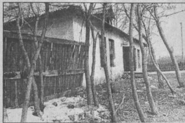
Вход в общежитие с. Подольск. Не трудно заметить мусор, битое стекло, пустые бутылки, грязные окна...
