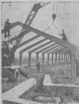
ЦЕЛИННЫЙ КРАЙ. В целинном совхозе имени Чехова Кустанайской области с помощью шефов-рабочих Соколовско-Сарбайского горнообогатительного комбината ведется строительство животноводческих помещений. В этом году будут сооружены из сборного железобетона 4 коровника. НА СНИМКЕ: строительство коровника в совхозе. Фото Е. Шулёпова.
